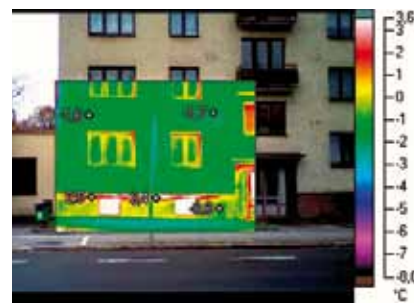
Teplo unikajúce z nezatepleného suterénu.
